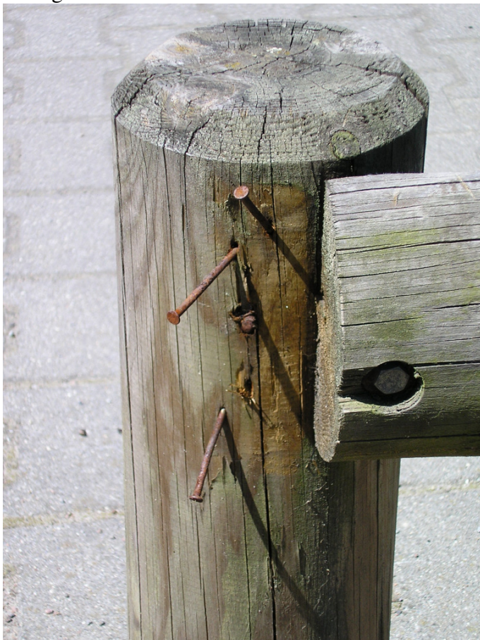
Krontalstraße: Straßen- bzw. Gehwegbegrenzung fehlt teilweise, nur rostige Nägel sind übrig. Schulweg, Gefahr für Kinder!
